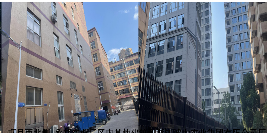
项目西北侧：欣邦实业厂区内其他建筑和浙江诚大实业集团有限公司厂房
